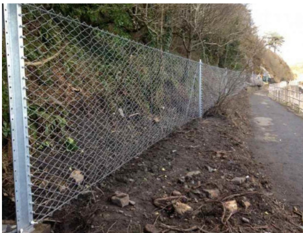
תמונה 4.1-1: גדר רשת למניעת דרדרת מתוצרת GEOBRUGG
